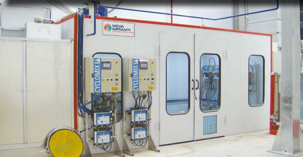
Forno asciugatura e sotto cabina di verniciatura manuale.
